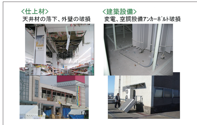
図24 新潟県中越地震 被害例(清水建設提供)
