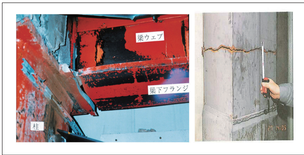
図15 1995年兵庫県南部地震における鉄骨柱、柱・梁接合部脆性破断(清水建設提供)
