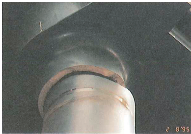
図17 1995年兵庫県南部地震 高速道路路鋼管の脆性破壊(清水建設提供)
