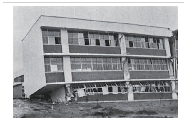
図11 1968年十勝沖地震での三沢商高の破壊(清水建設提供)
