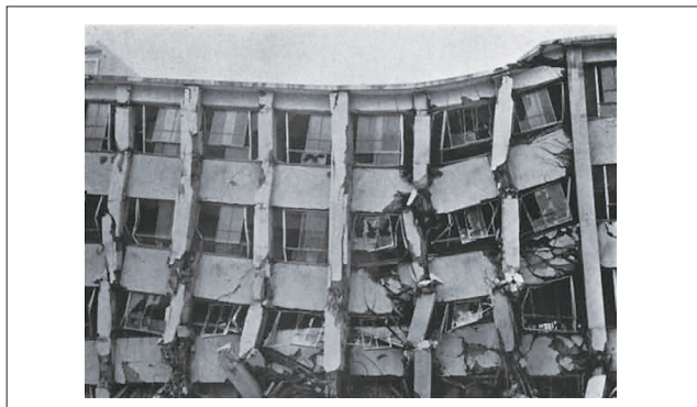
図10 1968年十勝沖地震時の函館大学の柱せん断破壊・余震後(清水建設提供)
