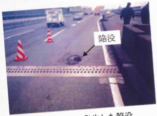
図2 路面に発生した陥没
